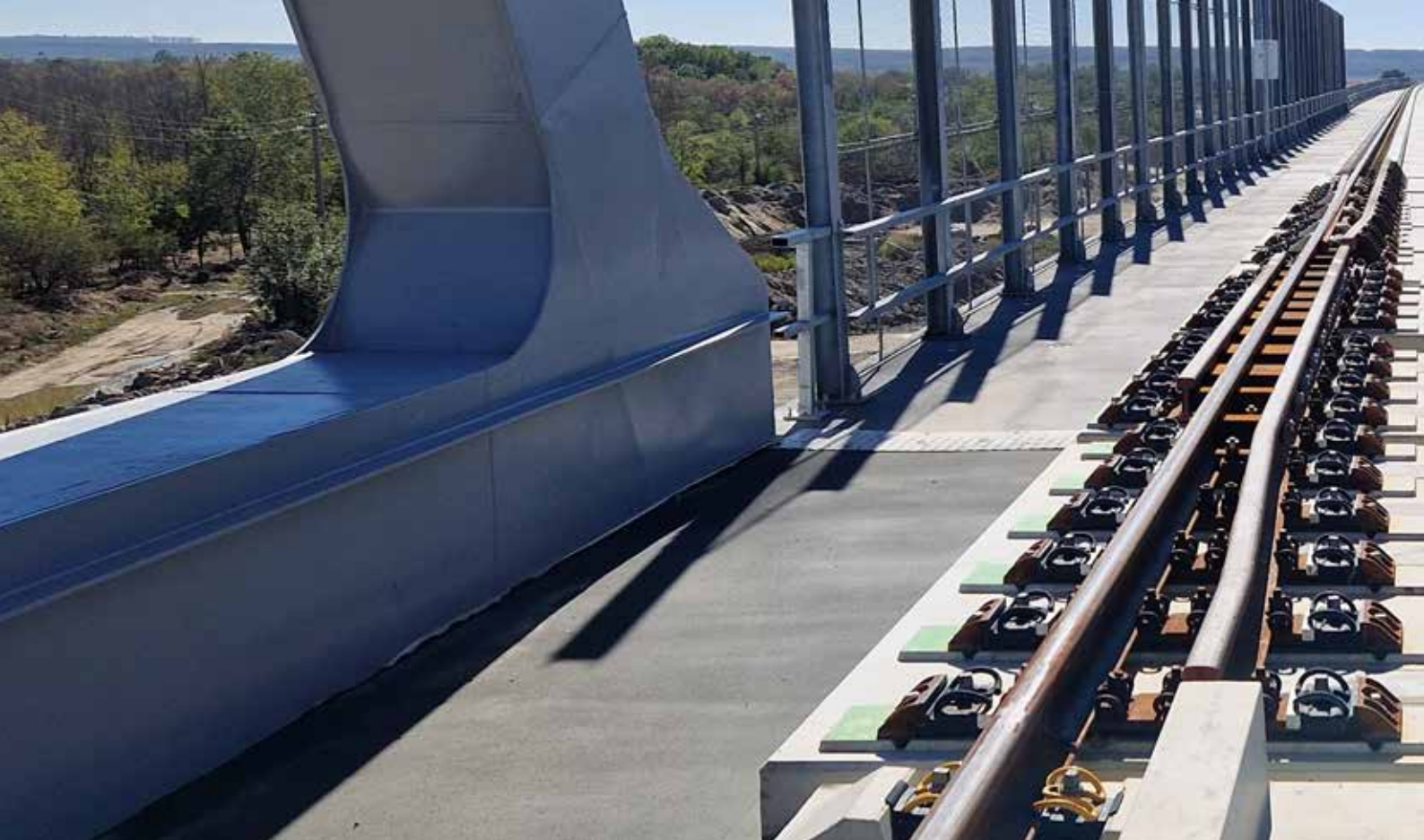
Schienenauszugsvorrichtung an der Brücke über den Fluss Argeş Grădiştea, Rumänien
